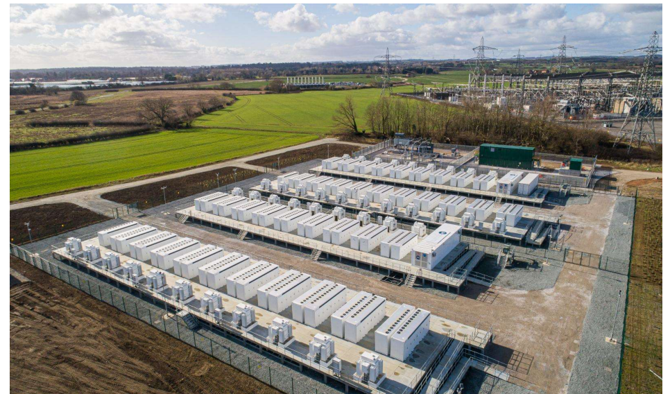
Batteri med kapacitet på 98 MW/196 MWh i Cottingham, Storbritannien fra 2022
